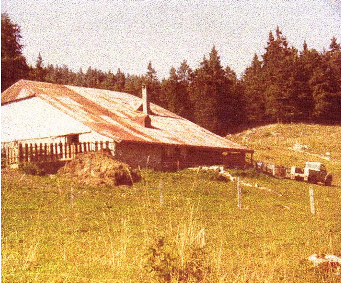
Les Grandes Cernies en 1982, avant la réfection complète du toit.
